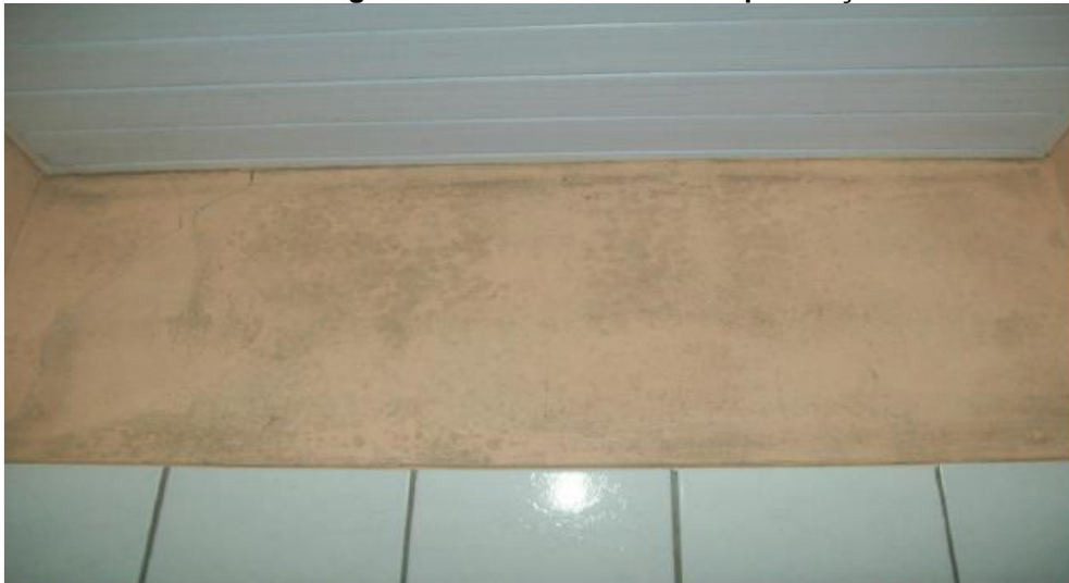
Figura 6 – Parede interna com presença de mofo
