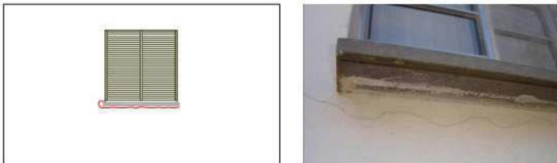
Figura 4 - Fissura horizontal na interface peitoril/esquadria
