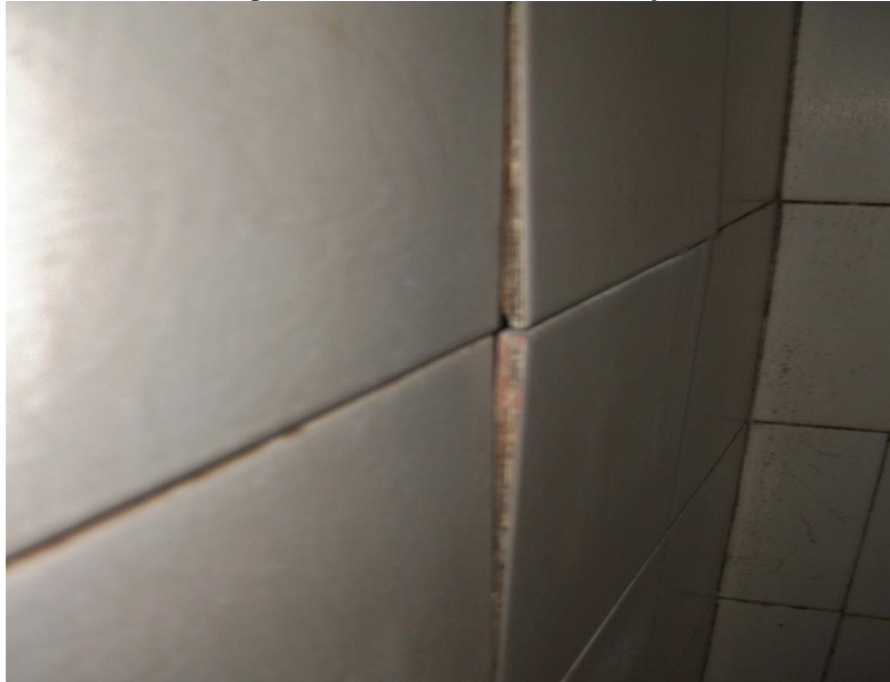
Figura 8 – Descolamento de azulejo
