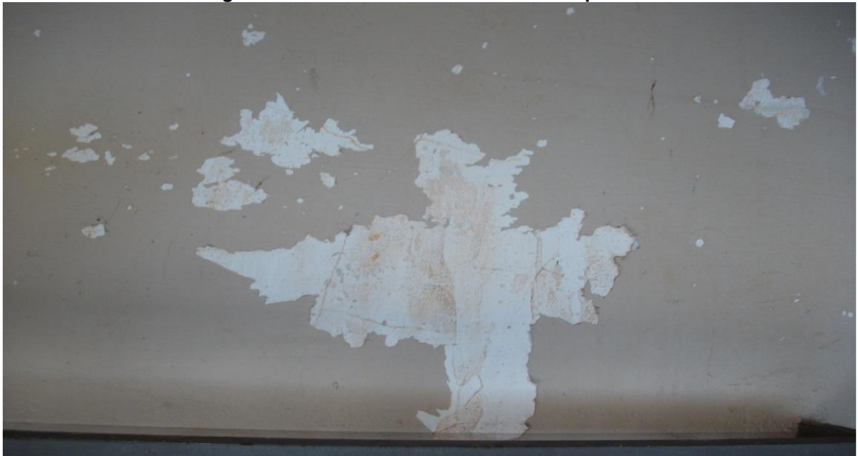
Figura 7 – Parede com descascamento da pintura
